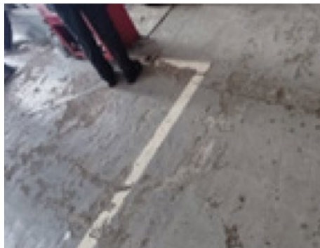
Desgaste superficial por baja resistencia al ataque mecánico
