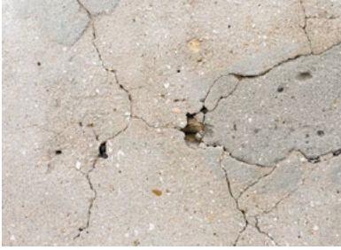
Fisuras de retracción
