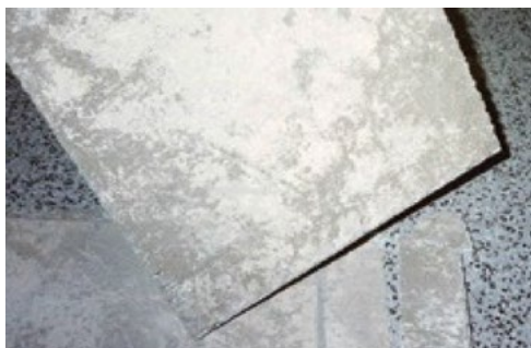
Revestimiento desprendido debido a una inadecuada limpieza del sustrato
