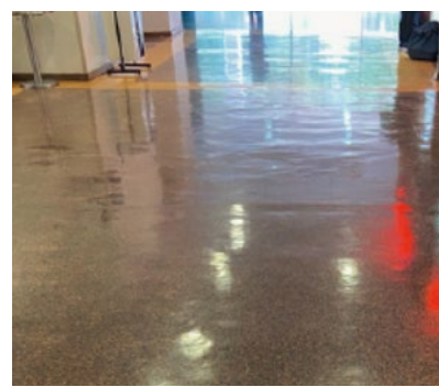
Marcas en el revestimiento
