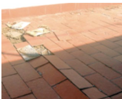
Desprendimientos causados por cargas de compresión que actúan sobre un revestimiento exterior por falta de juntas
