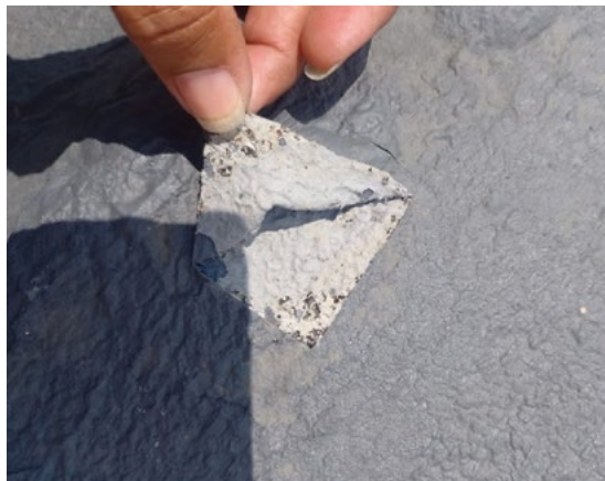
Desprendimiento por humedad
