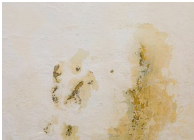
Residuos y contaminación del área
