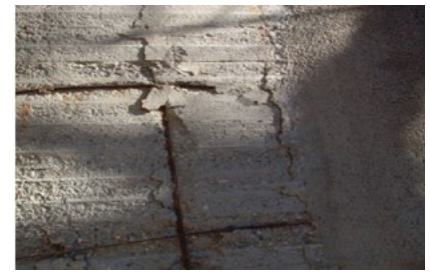
Irregularidad en la superficie que afecta la continuidad de la impermeabilización
