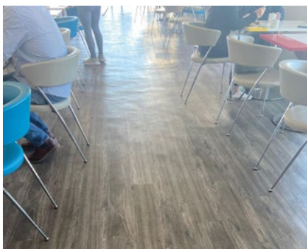
Defectos visibles en el piso vinílico
