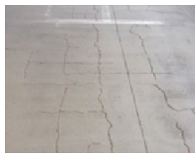
Juntas despicadas y fisuras
