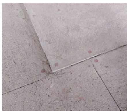
Sustratos no aptos para la instalación de revestimientos
