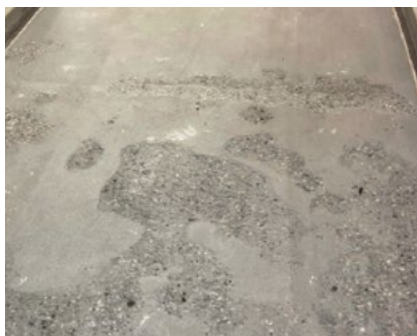
Pérdidas de sección por desgaste
