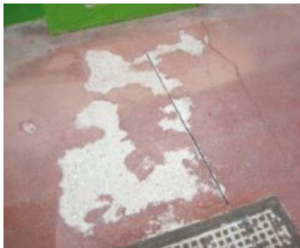
Desprendimiento del acabado del piso por inestabilidad del soporte
