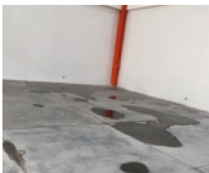
Presencia de humedad en la losa
