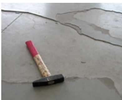
Desprendimiento de un sistema de piso de alto espesor, por falta de preparación correcta
