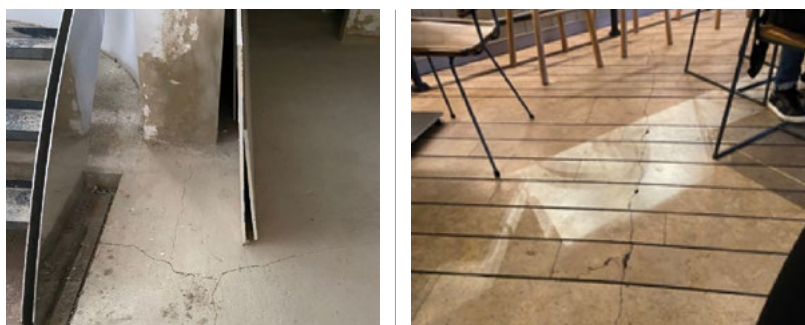
Fisuras y grietas no tratadas en el sustrato afectan los revestimientos y el acabado
