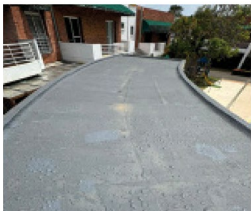
Presencia de burbujas por humedad en el soporte
