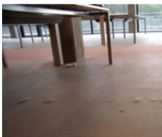
"Globos" aparecen a lo largo de la fisura
