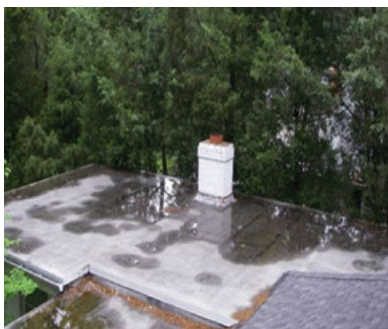
No hay pendiente adecuada
