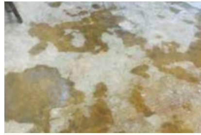
Desprendimiento por falta de preparación
